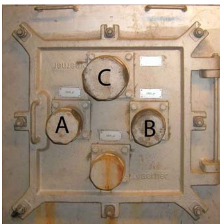
Figur 12. Mätportar i manlucka under överhettarna.
